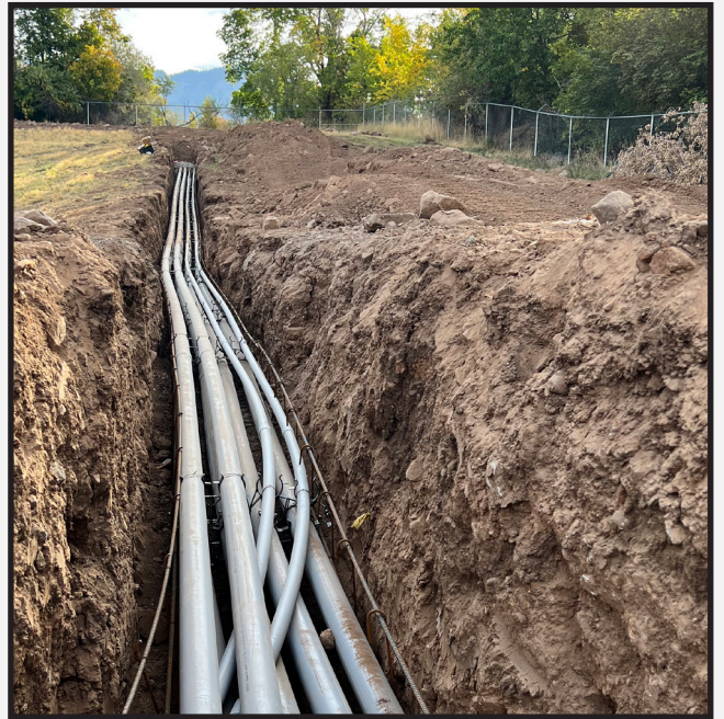
Conduit duct bank
